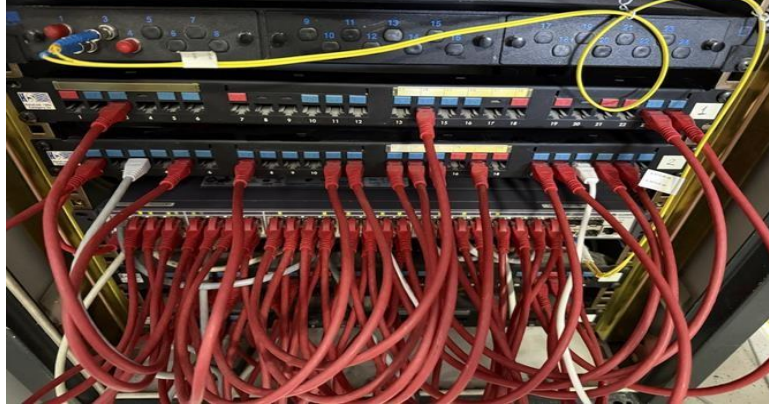
Şekil 14. Ağ altyapısı modernizasyonu kapsamında kurulan yönetilebilir (akıllı) switch'ler ve yenilenen bağlantı altyapısı.
